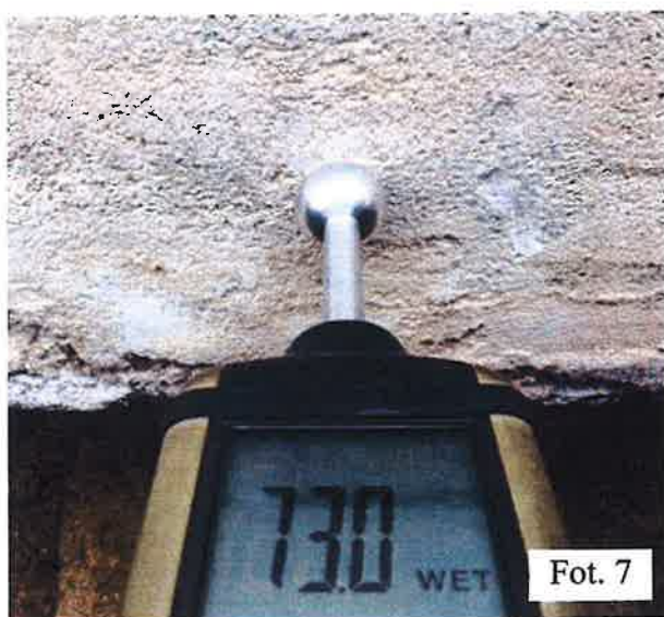
↑ Fot. 7 – Wysoki stopień zawilgocenia tynku 73,0/100jc. Tynk ściany północnej sięga 30 cm poniżej powierzchni przy ścianie, fot. 11. (73/6,25 \approx 11,7% wilgotności masowej)
