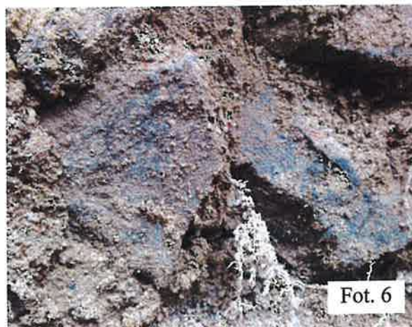
↑ Fot. 6 – Mur fundamentowy z kamienia na zaprawie wapiennej. Widoczne gołe kamienie bez izolacji przeciwwilgociowej.
