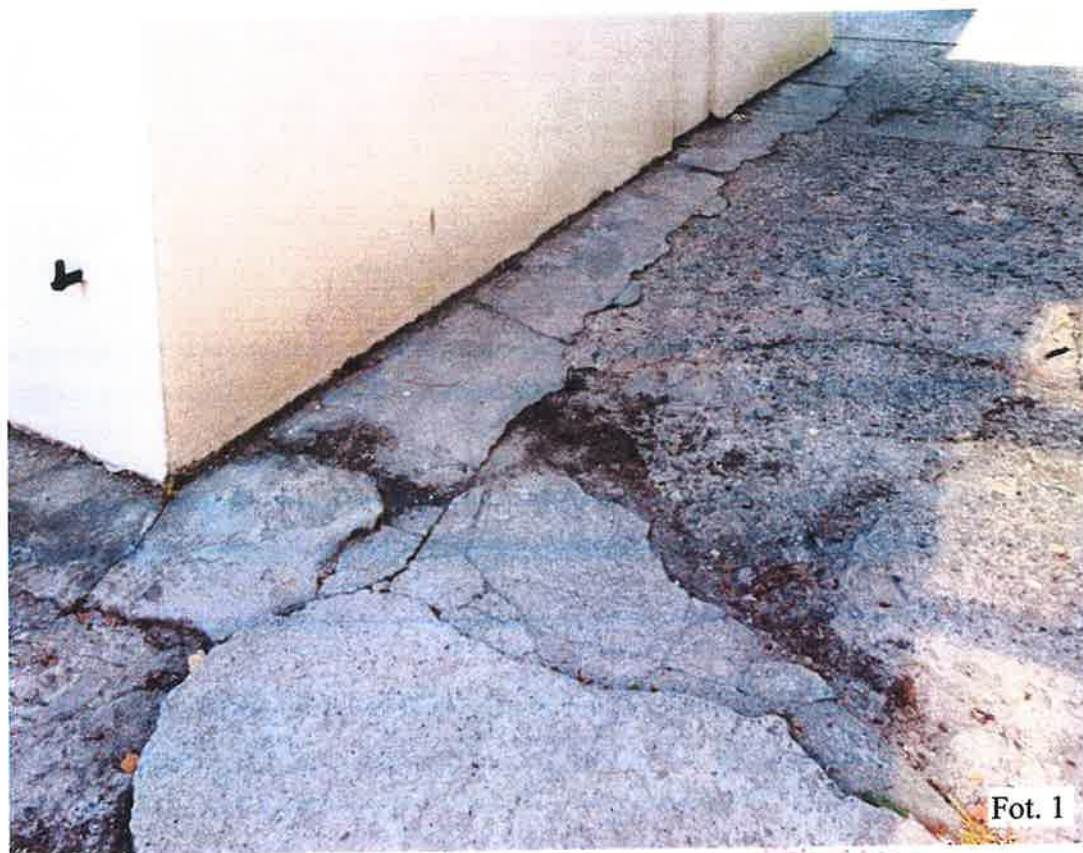
↑ Fot. 1 – Spękana i nieszczelna nawierzchnia betonowa z kraterami i zagłębieniami na placu przy ścianie północnej.
