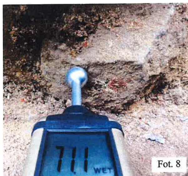
↑ Fot. 8 – Wysoki stopień zawilgocenia fundamentu z kamienia 71,3/100jc. Fundament bez izolacji p-wilgociowej. (71,3/6,25 \approx 11,4% wilgotności masowej)
